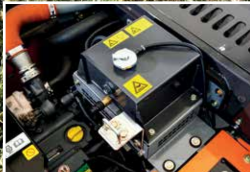
Ekspanstanken forhindrer at motordeler overoppheites.
